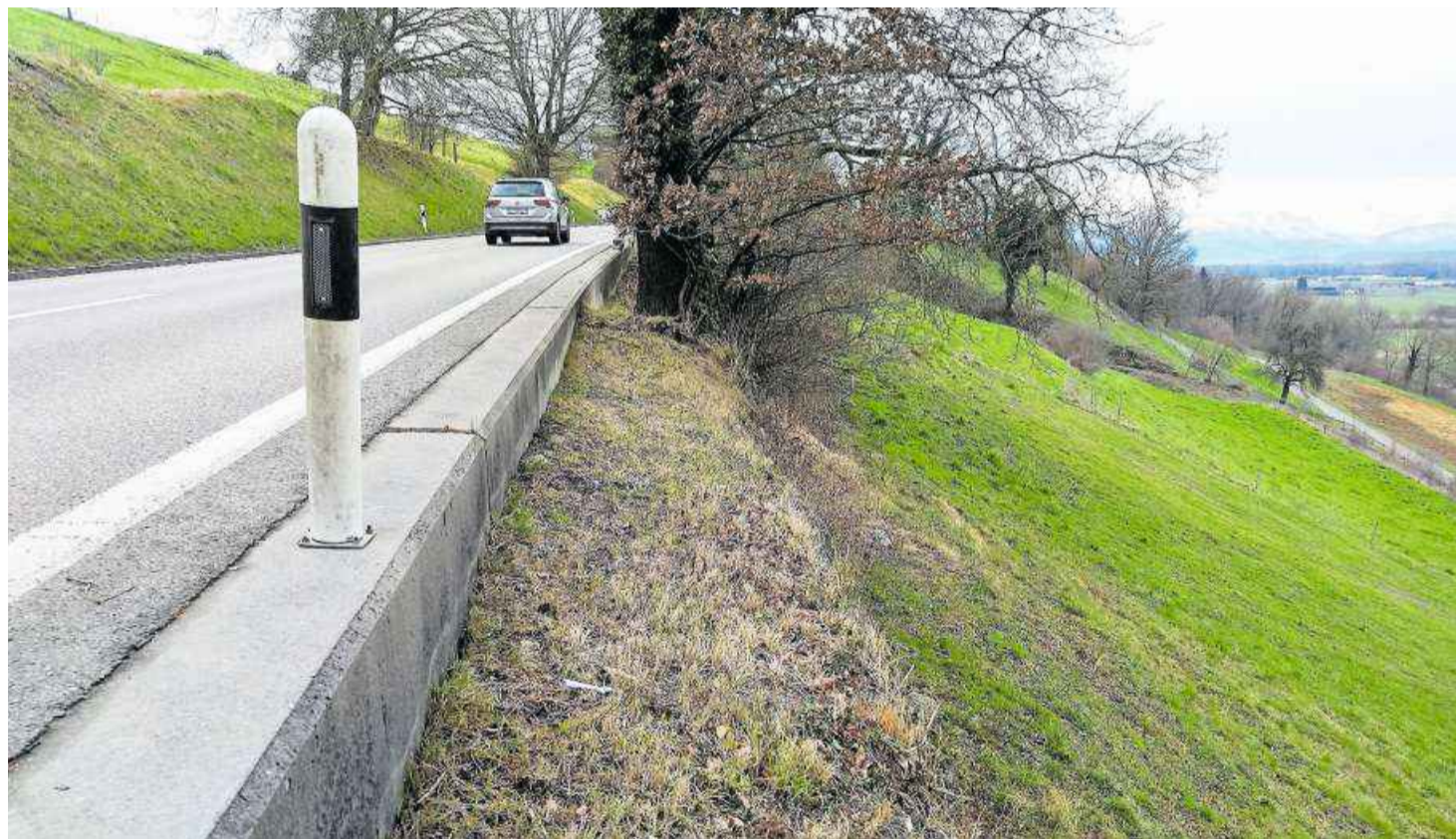
Die Kantonsstrasse zwischen Unter- und Oberlunkhofen weist «offensichtlich akute sicherheitsrelevante Mängel» auf. Bild: Eddy Schambron
